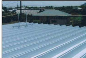
⑧親綱を取付け、緊張器を用いて概ね水平になるように設置して完成。
