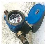
水道メーター
