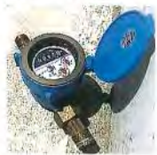
水道メーター
