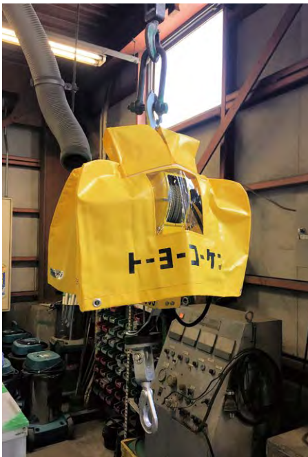
■漏電事故防止に
